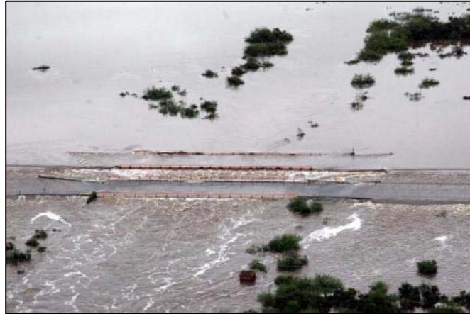
Puente de la autopista sobre el arroyo Colastiné, afectado por lluvias extraordinarias
